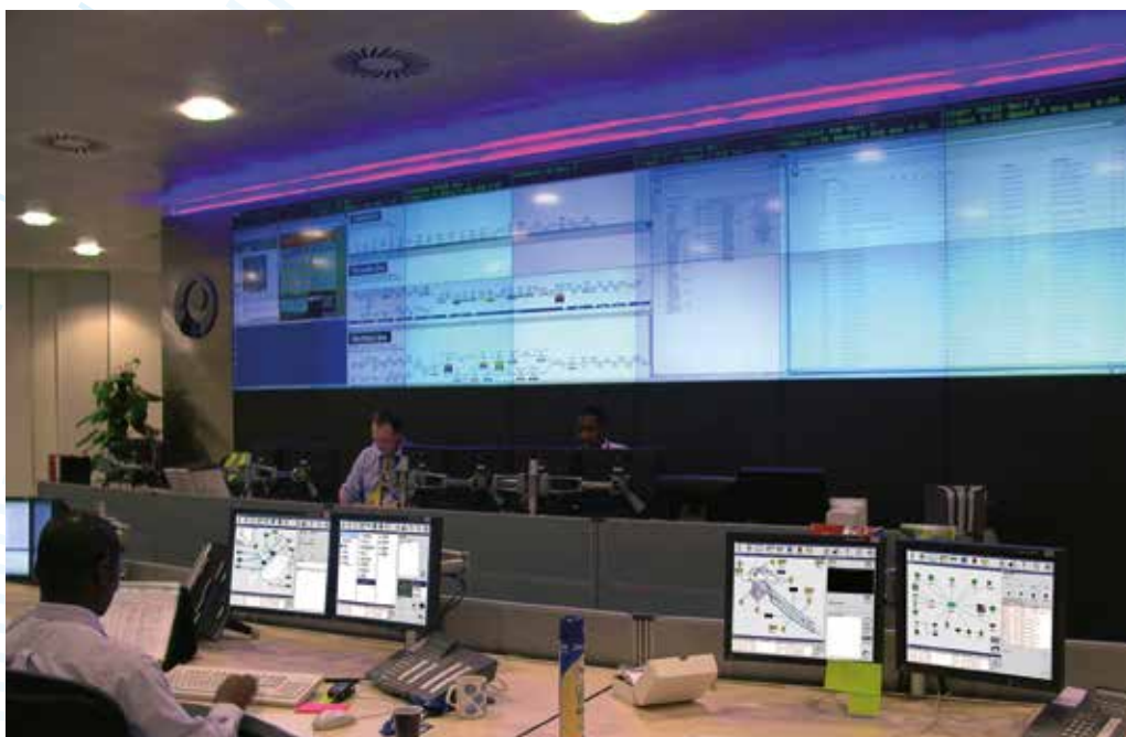
Panorama E 2 utilisé au centre de contrôle Tubelines
