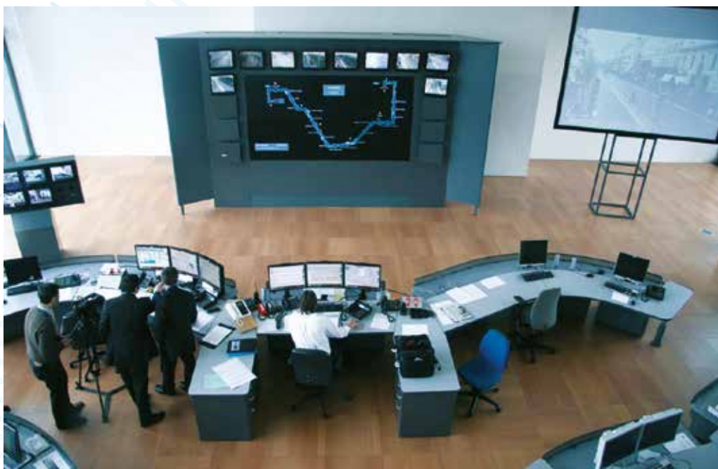
PCC : Poste de Commandement Centralisé. Le TCO (tableau de contrôle optique) piloté par Panorama E 2 informe sur l'état de la ligne de tramway.
