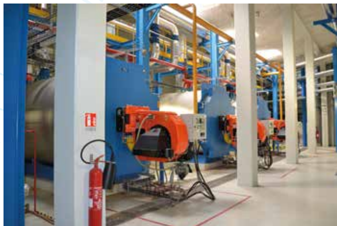
24MW de puissance de chauffage produits par 3 chaudières eau chaude
