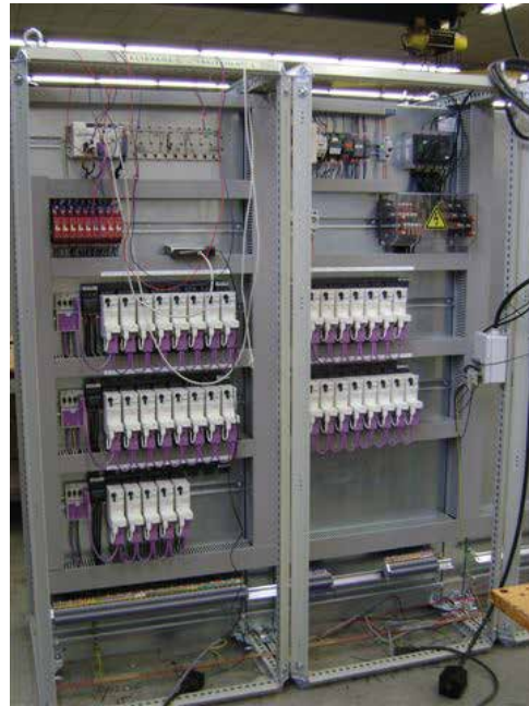
Local BT rénové
