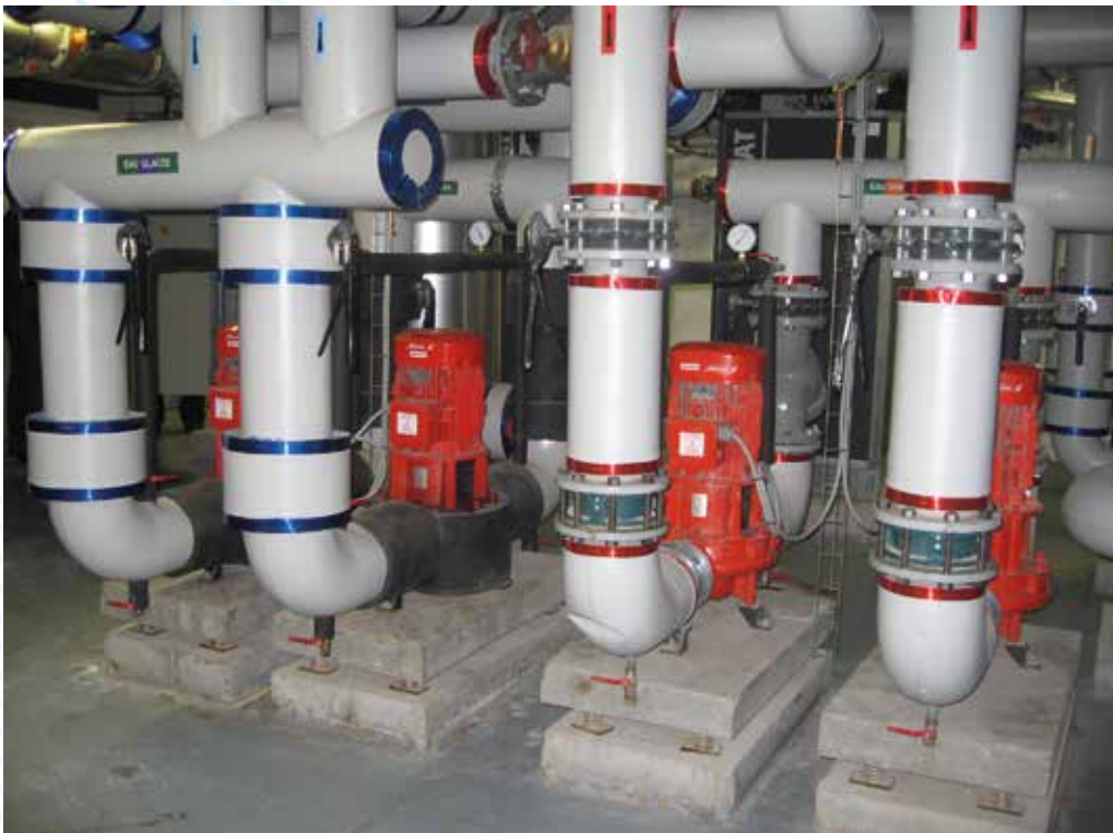
Local technique où se situent les pompes à chaleur et condenseurs
